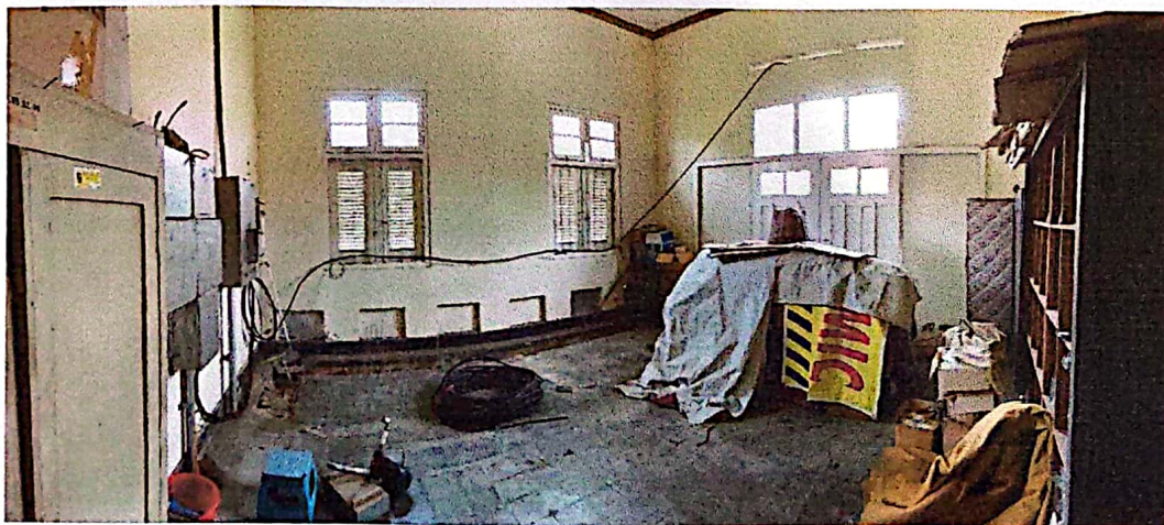
Foto 10. Ruang Bagian Dalam Panel Listrik Bangunan Utama
