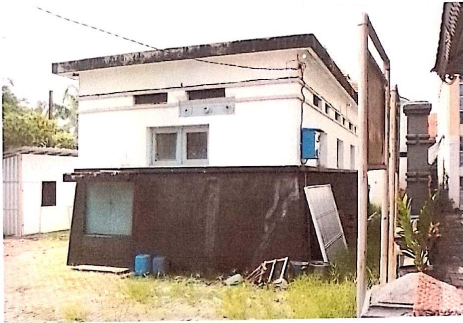
Foto 3. Bangunan Gardu Listrik Tampak Samping Utara Dengan Jendela Besar Dari Plat Besi
