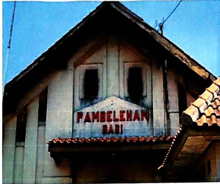
Foto 15. Tampak Bangunan Rumah Pemotongan Hewan Babi Bagian Atas Dengan Lubang Sirkulasi Udara
