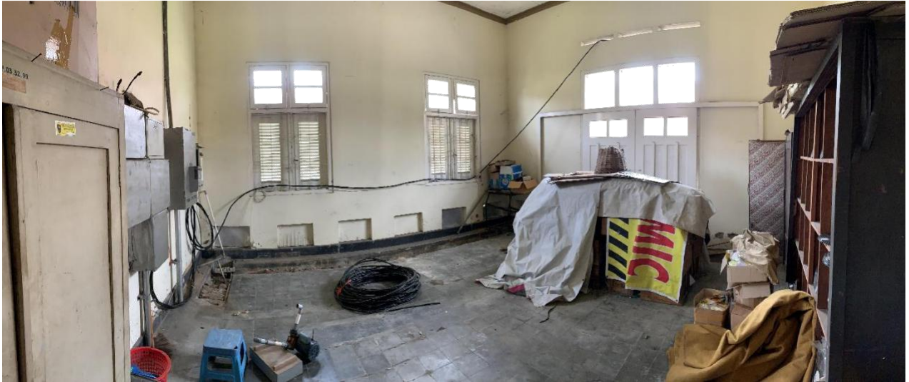
Foto 10. Ruang Bagian Dalam Panel Listrik Bangunan Utama
